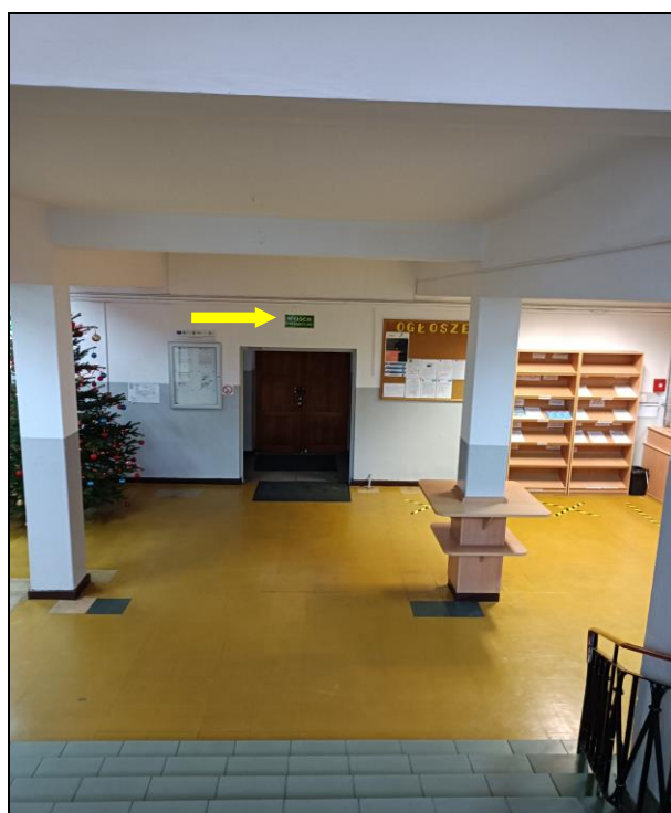
Oznakowanie wyjścia ewakuacyjnego z budynku
