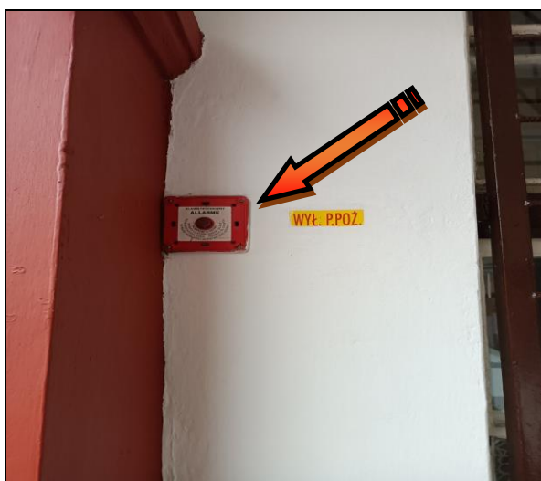
Przeciwpożarowy Wylącznik Prądu - po lewej stronie głównego wejścia do budynku
