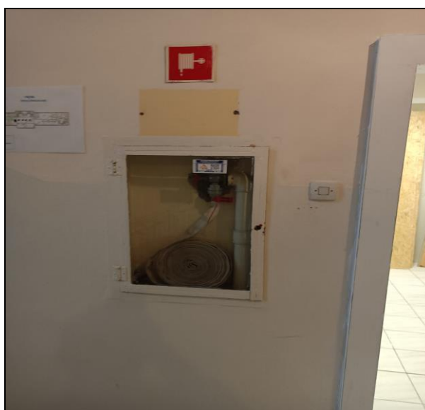
Hydrant wewnętrzny DN25
