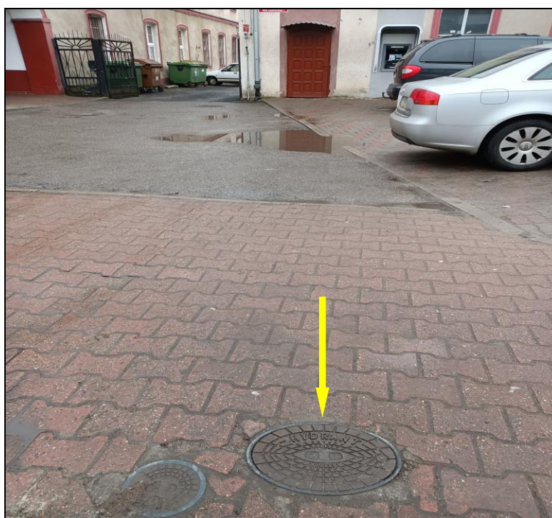
Hydrant podziemny DN80 od ul. Kilińskiego
