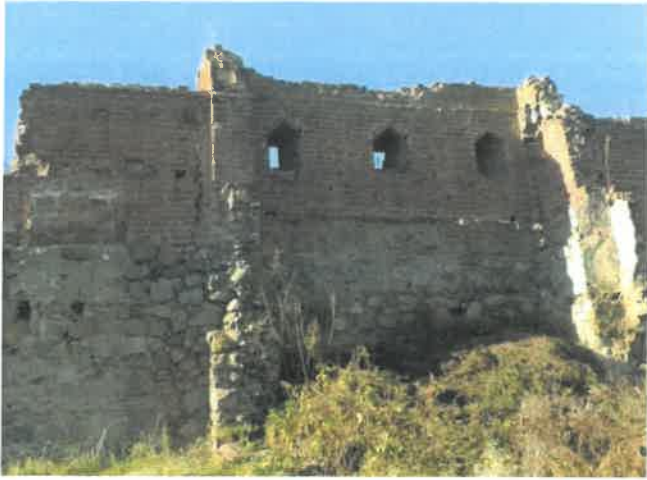
Zniszczony fragment muru z czatownią
